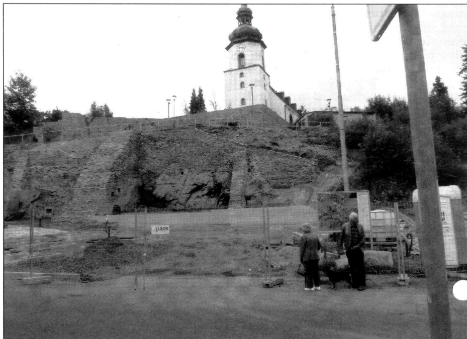
Die Baustelle am Marktplatz. Hier ist laut Zeitungsbericht auf dem ehemaligen Großkopf-Grundstück die Naturschiefertreppe hinauf zur Kirche sowie weitere Projekte geplant.
